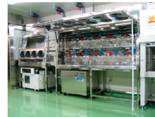
図1) 高度安全動物飼育実験室(A棟1階) バイオセーフティレベルP3の感染実験が行える高度危険病原体動物実験室である。本実験室の利用により、腎臓性出血熱の病原体単離に成功し、クロイツフェルトヤコブ病、ATL、AIDSなどの病原因子に関する動物実験が安全かつ円滑に行えるようになった。
